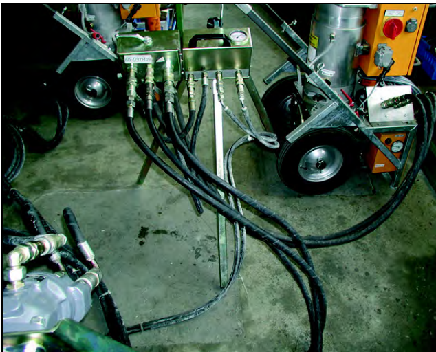
Bild 5.35 Seilantriebsrad-Hydraulikmotor, Mengenteilerpult, HSP-12 und HAG-328 angeschlossen (von links unten nach rechts oben)
